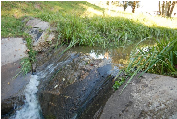
6.2.Bojātā pārgāzne Vienziemītes monitoringa stacijā 2013. g. septembrī.
