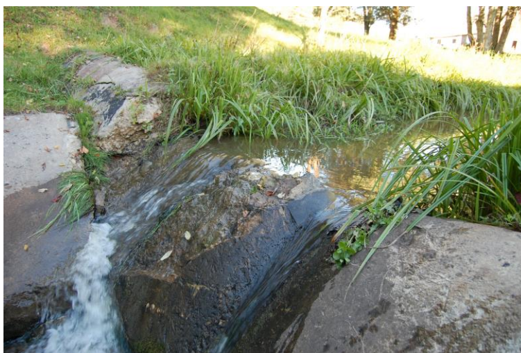
5.2. Bojātā pārgāzne Vienziemītes monitoringa stacijā 2013. g. septembrī.
