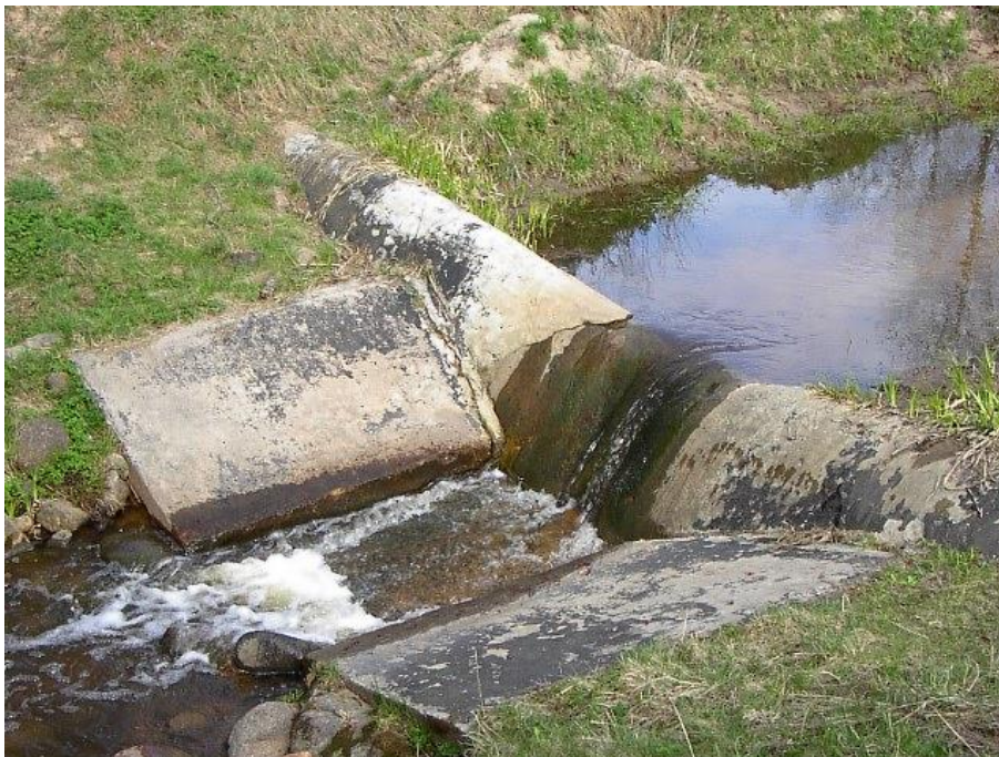
5.1. Kombinētā profila pārgāzne Vienziemītes monitoringa stacijā 2004. gadā.
