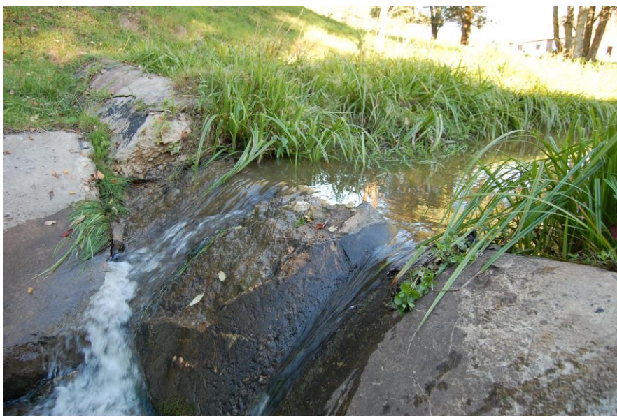
5.2. Bojātā pārgāzne Vienziemītes monitoringa stacijā 2013. g. septembrī.
