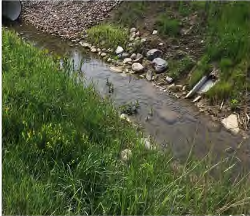
50. att. Drenu kolektors pirms Bērzes 2.vietas grāvja beigu caurtekas.
