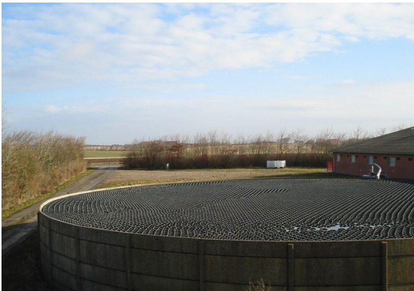
15. attēls. Šķidrmēslu krātuve ar plastmasas materiāla pārsegumu
